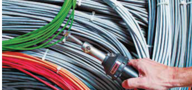
Aanbrengen van een gesoldeerde krimpverbinding met behulp van de HOT JET S en opgeschoven zeefreflector.
